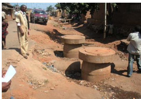
La 8 ème avenue à Bwiza, érodée par les eaux pluviales
